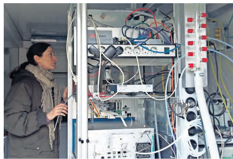
Kabelgewirr: Im Inneren der mobilen Messstation überprüft Uta Wolf-Benning beim Aufbau die Instrumente zur Überprüfung der Luftqualität FOTO: NEHLS
